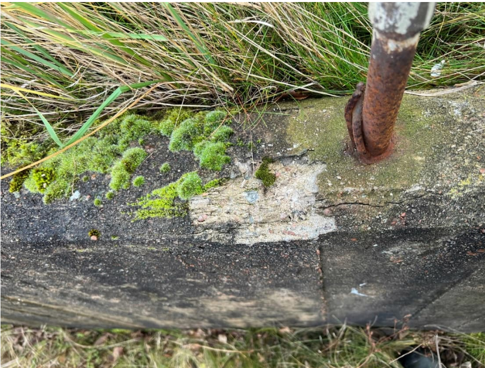
Figur 7. Typskada, sprickbildning, vittring och påväxt.
