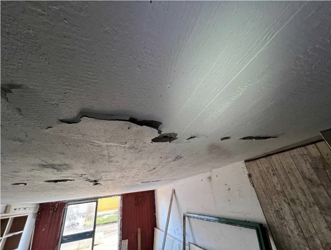
Figur 20. Skyddsrum S. entré, detalj, spjälkning tak.
