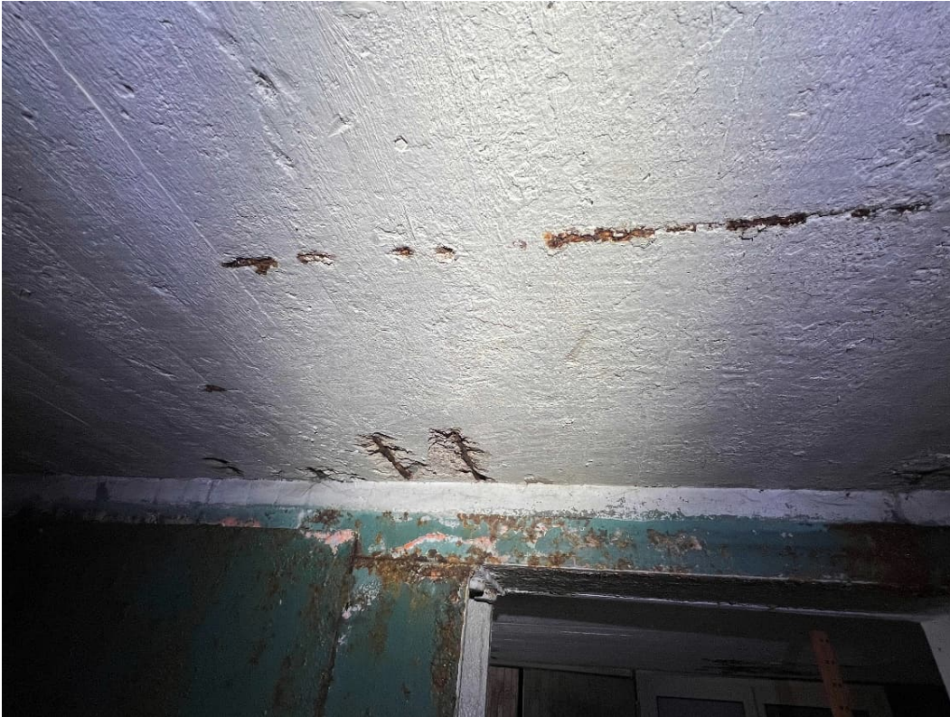
Figur 22. Skyddsrum S. innanför dörr T.H, spjälkning tak.
