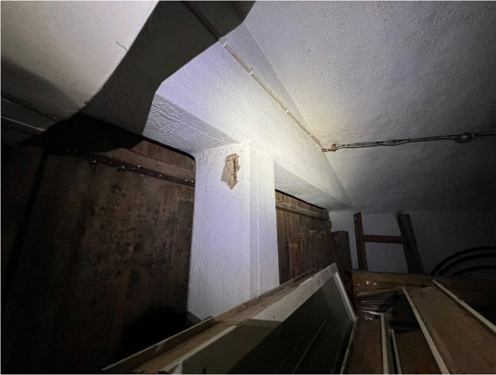
Figur 24. Skyddsrum S. spjälkningsskada pelare.
