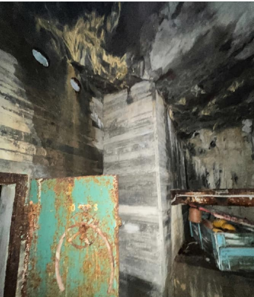
Figur 17. Tunnel N. Vatteninträngning.
