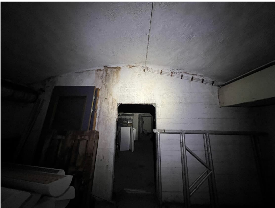
Figur 23. Skyddsrum S. fuktrinrängning vid vägg.
