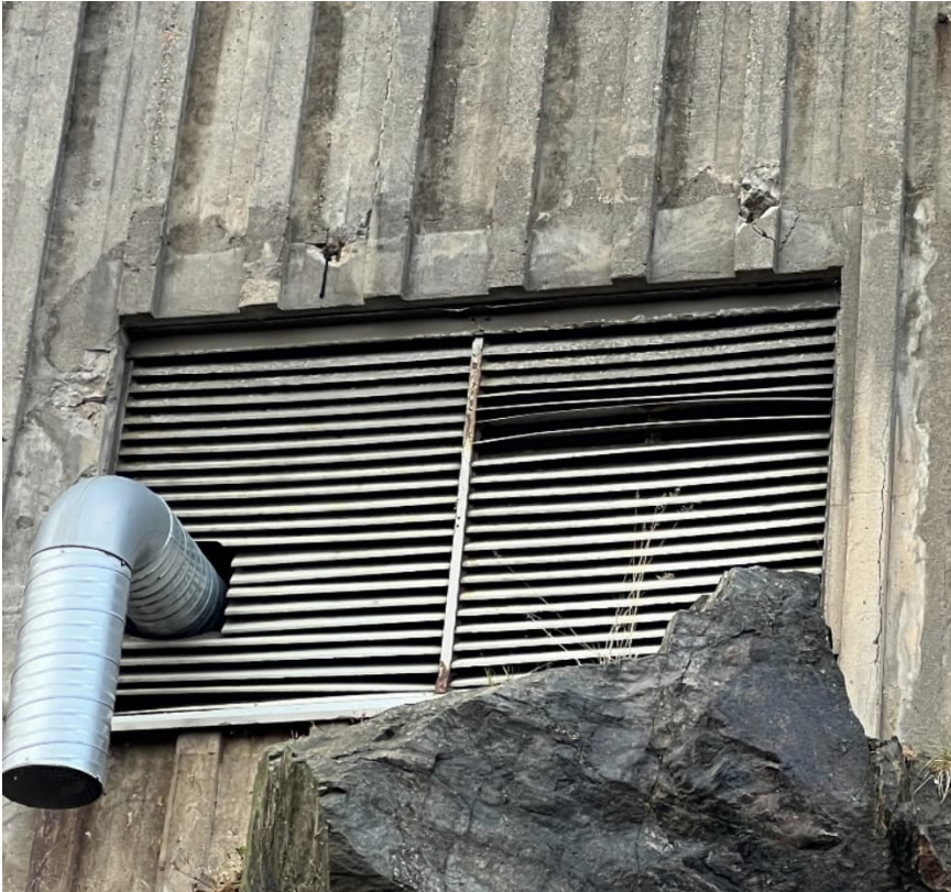
Figur 9. Skador kring ventilationsgaller östra stödmuren.
