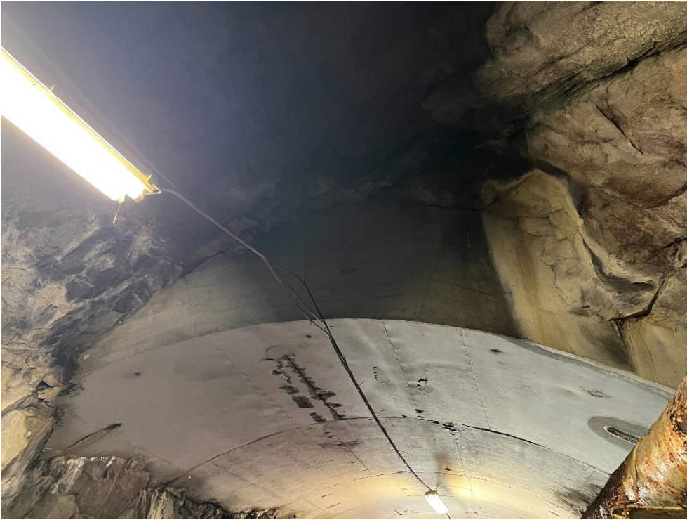
Figur 14. Tunnel N. tak uppgjutet mot berg.
