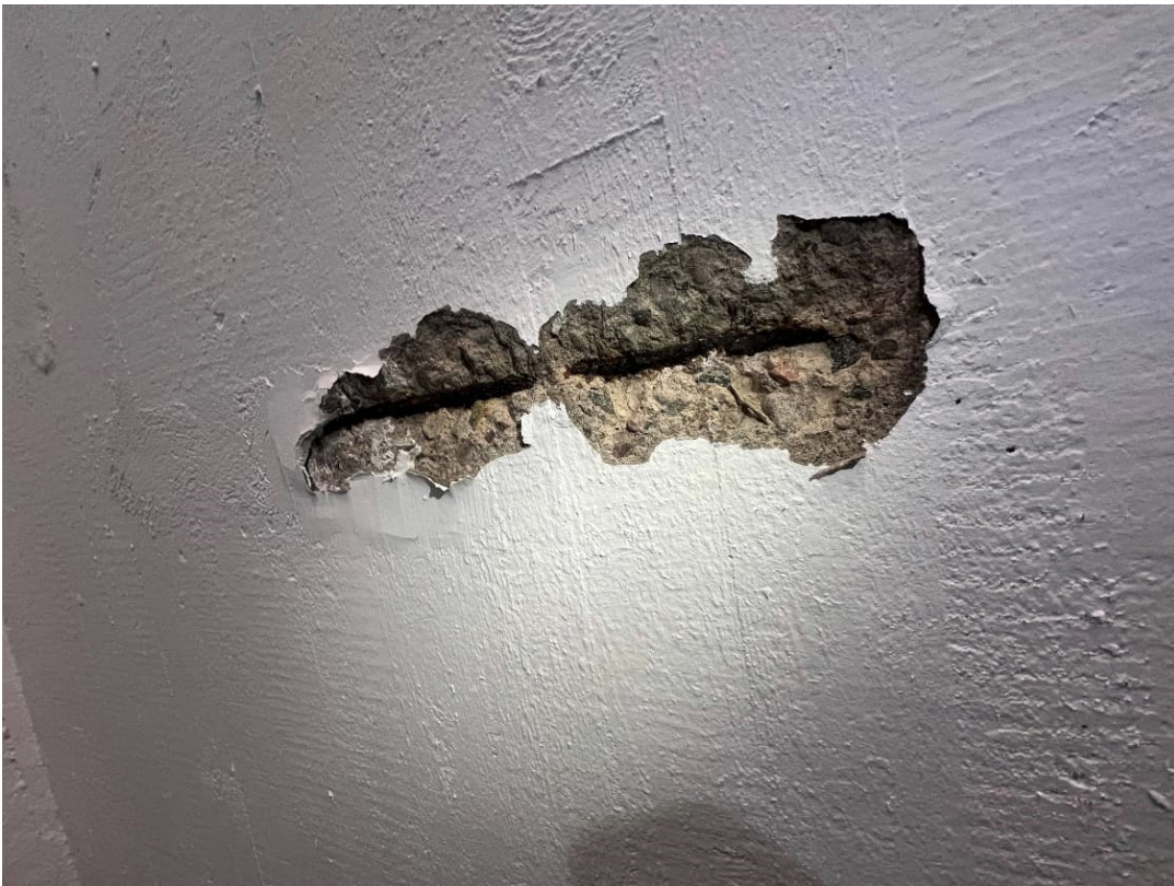
Figur 19. Skyddsrum S. entré, detalj, spjälkning tak.
