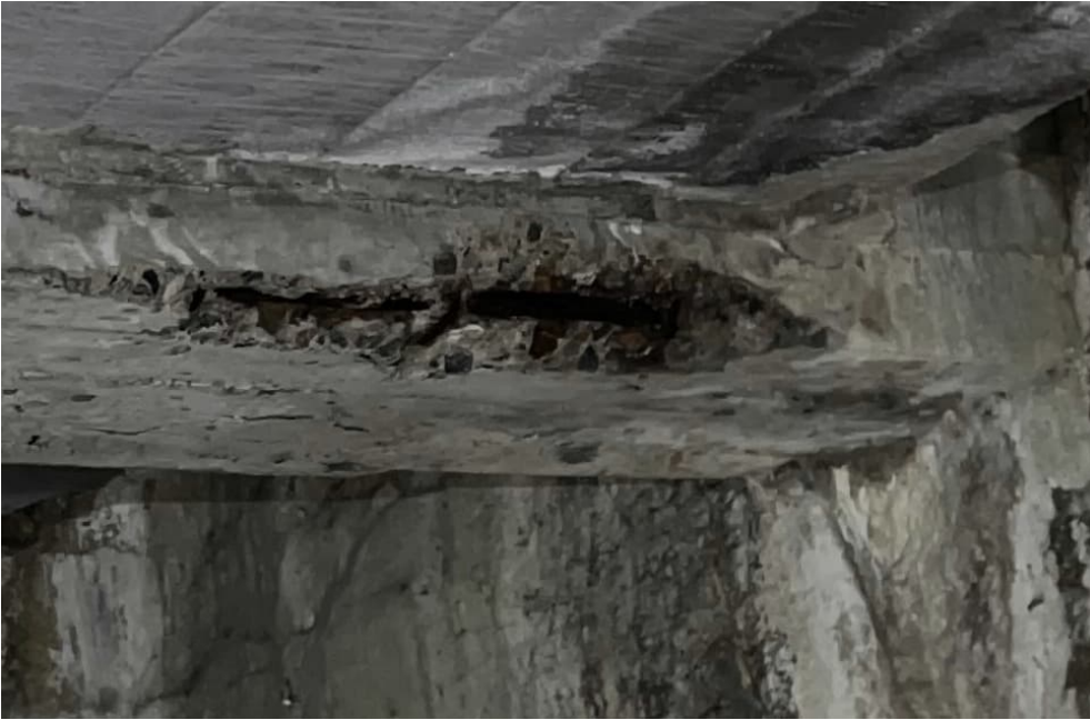
Figur 11. Grund Begonia, detalj, skada på balk.
