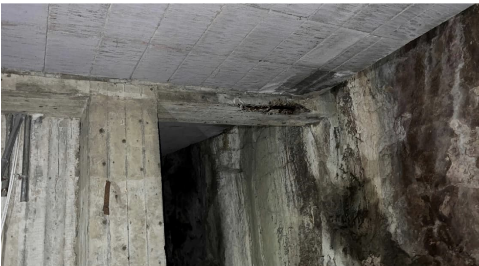
Figur 10. Grund Begonia, skada på balk.
