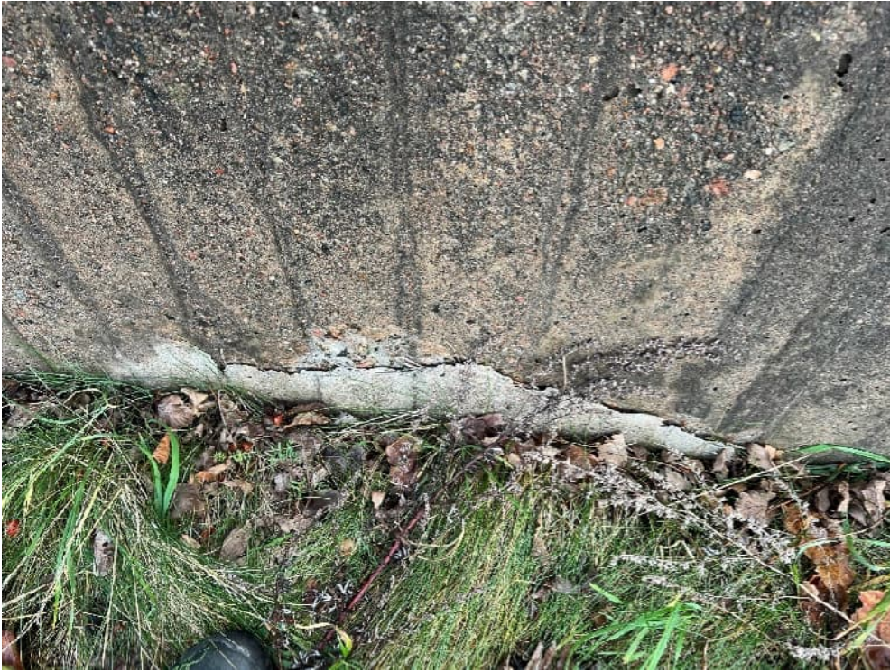
Figur 6. Lagning med sprickor, västra muren.
