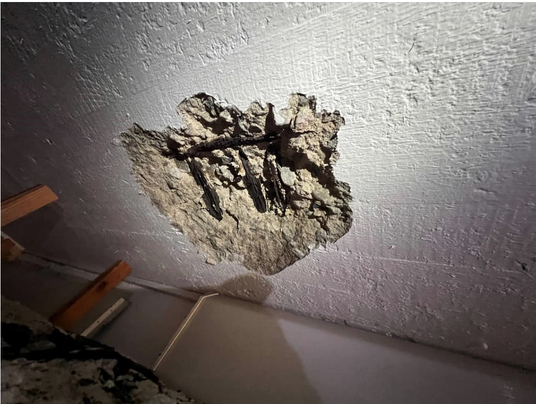
Figur 21. Skyddsrum S. entré. Detalj, grovt korroderad, exponerad armering.
