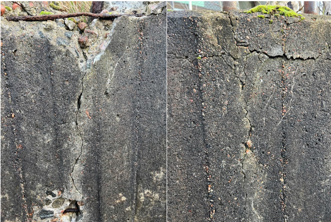
Figur 5. Typskada, sprickor med spjälkning.
