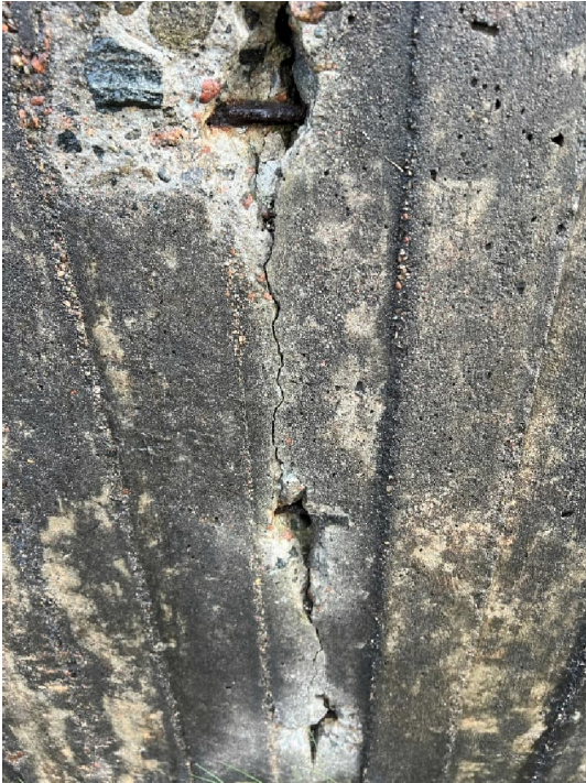
Figur 4 Typskada, västra muren, spricka med karbonatisering och spjälkning som följd.
